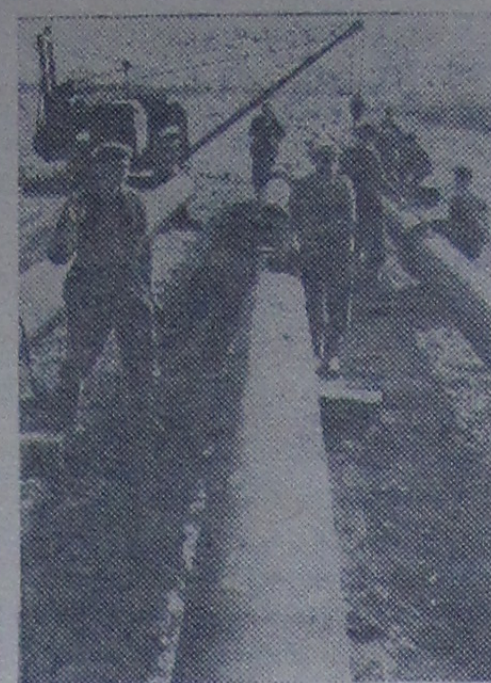
ВЕНГЕРСКАЯ НАРОДНАЯ РЕСПУБЛИКА. С большим энтузиазмом трудятся строители венгерского участка нефтепровода «Дружба».
