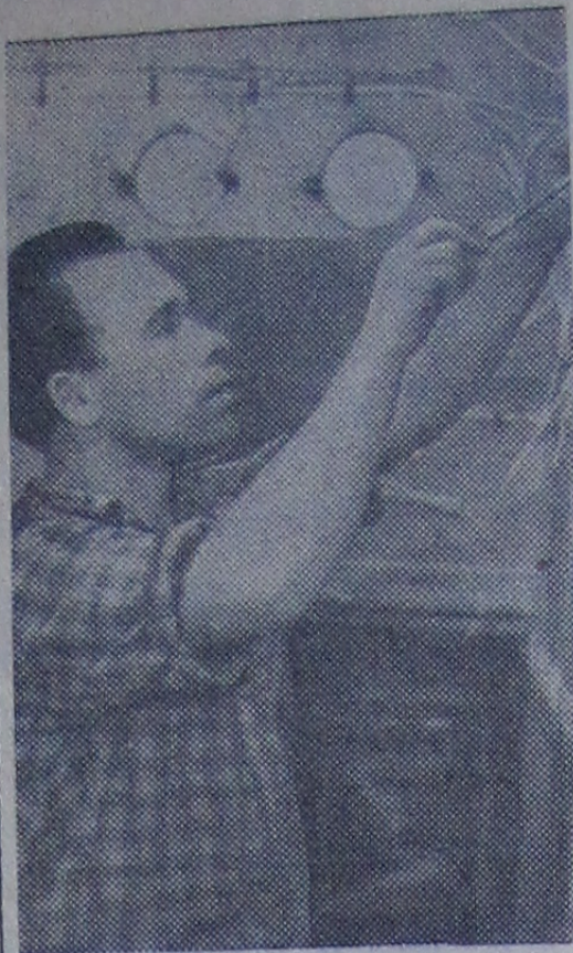
Эксплуатационники Ивановской ГЭС производят сейчас большой капитальный ремонт статора генератора. Энергетики станции, борющиеся за звание коллектива коммунистического труда, обязались в честь XXII съезда КПСС выполнить работу за 48 дней.
