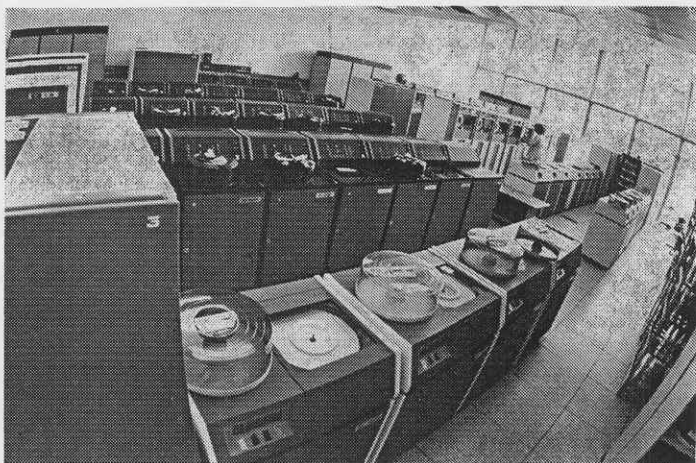
В машинном зале ЛВТА.
